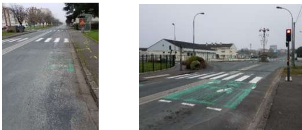
Figure 28 : les marquages au sol de la bande cyclable située sur l'avenue Gaston Cambot disparaissent progressivement
